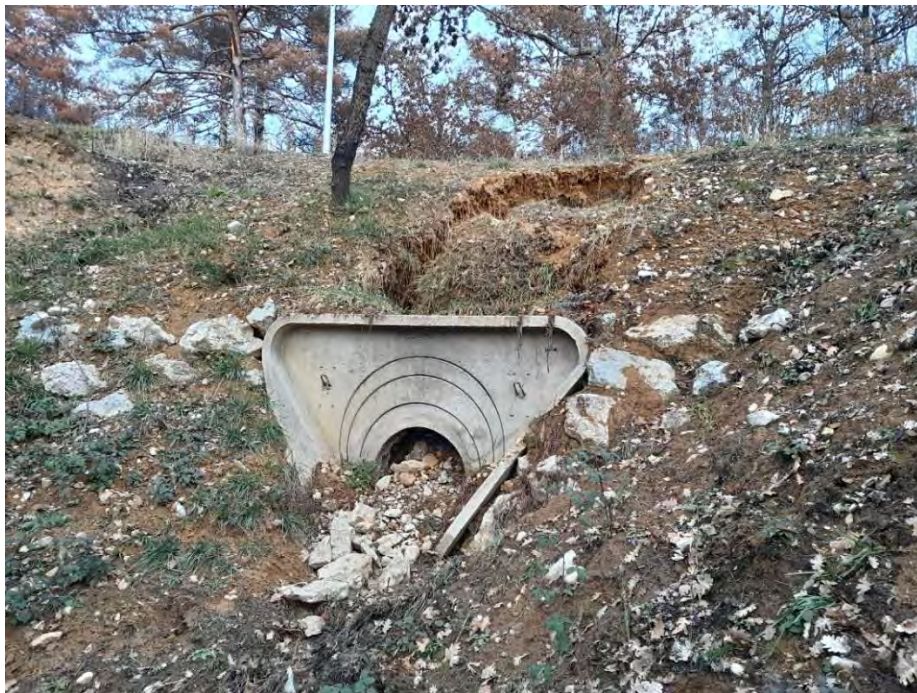
Figure 40 : vue de la tête aval de la traversée de chaussée avec les traces d'une érosion régressive (ravine 3)
