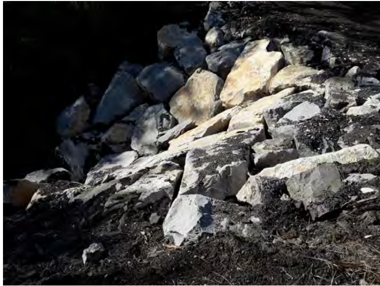
Figure 51 : vue d'un enrochement sec disposé à l'aval d'une piste limitant l'érosion régressive
