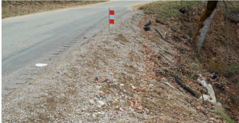
Figure 37 : érosions de la tête du talus aval remblayée par des graviers (ravine 2)
