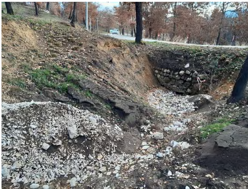
Figure 41 : érosions de la tête du talus aval remblayée par des graviers (ravine 4)
