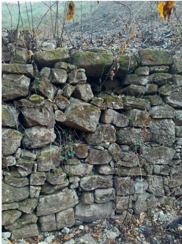
Figure 35 : photo des pierres manquantes dans le seuil (ravine 1)
