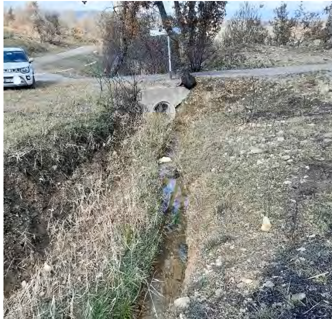
Figure 48 : débordements possibles à l'amont de la buse
