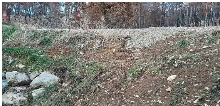
Figure 42 : érosions de la tête du talus aval remblayée par des graviers (ravine 4)
