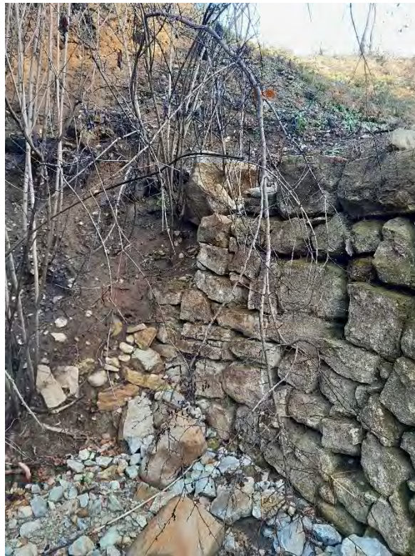
Figure 34 : : seuil contourné en rive droite (ravine 1)
