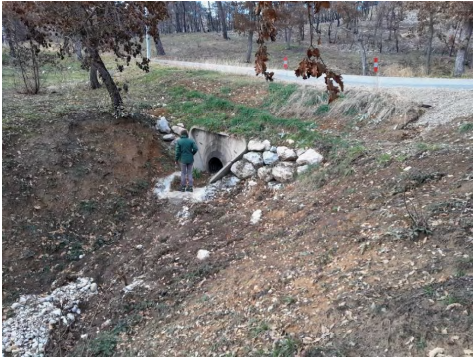
Figure 43 : vue de la tête aval de la traversée de chaussée avec les traces de surverse (ravine 4)
