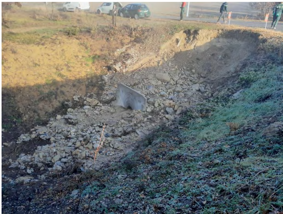
Figure 32 : traces d'une érosion régressive à l'aval de la RD216 (ravine 1)
